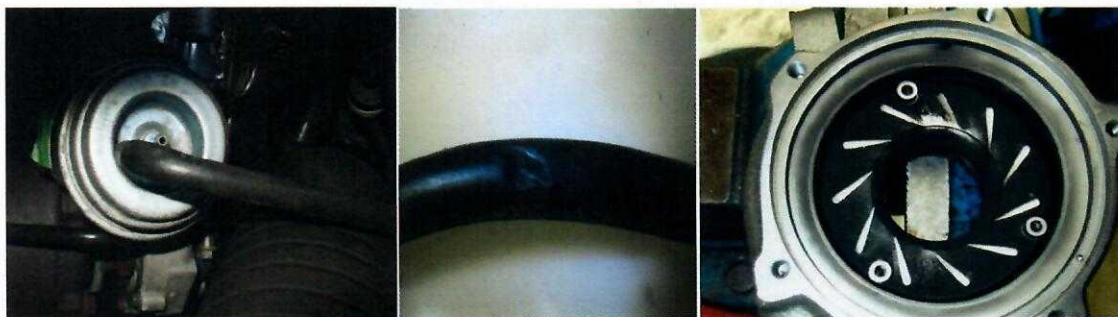
Fig. 8.34. Furtun de vacuum sărit Fig. 8.35. Furtun vacuum Fig. 8.36. Urme de staționare ale vanelor – turbina nu a fost acționată
